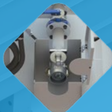
Descarga Sistema spill box com engate rápido que permite o reaproveitamento do combustível.
